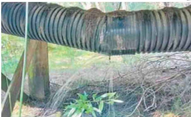
La avería en unión de dos tuberías provocó el vertido.
