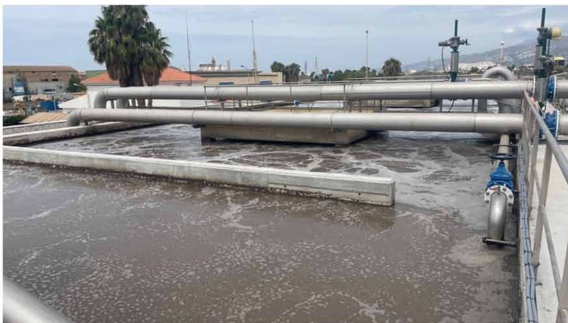
EDAR de Motril (MANCOMUNIDAD)
